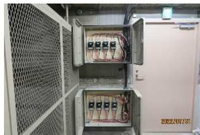
エレベータ電源切替器
