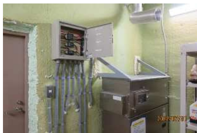
増圧ポンプと電源切替盤
