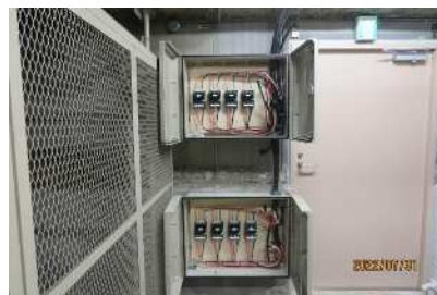
エレベータ電源切替器
